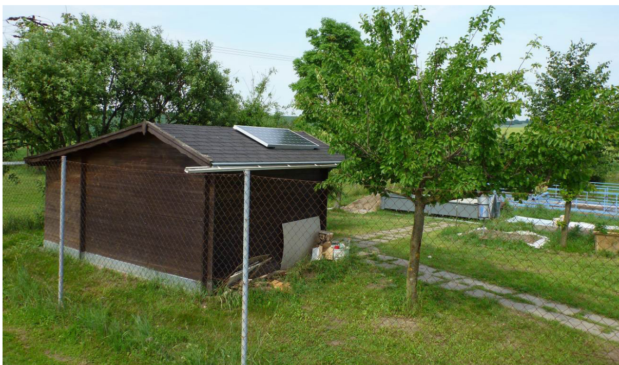
Obr. 19: Fotovoltický panel na pohon dávkovacieho čerpadla pripevnený na streche obslužného objektu
