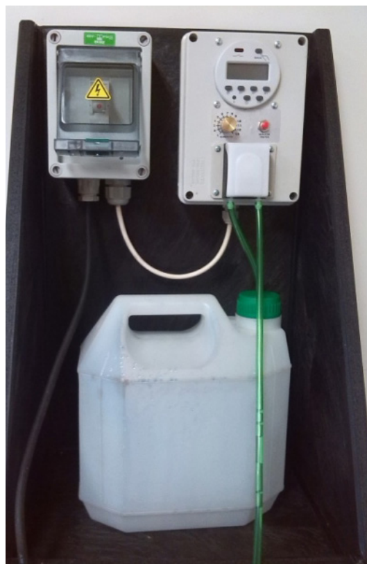
Obr. 18: Jednotka na zrážanie fosforu
